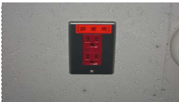
非常用コンセント
