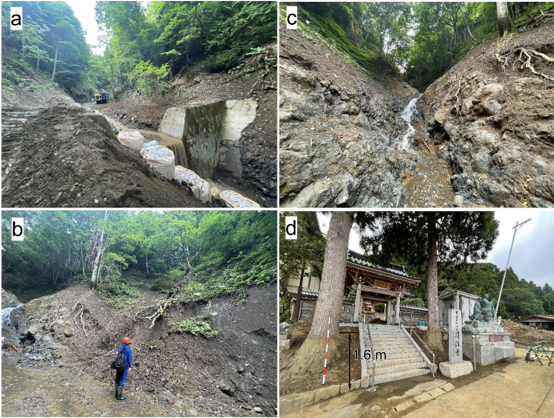
図2 (a) 堰堤の様子 (b) 溪岸に堆積した崖錐堆積物 (c) 河床の露岩状況 (d) 土砂の堆積痕跡 (撮影日:2022. 8. 29)
